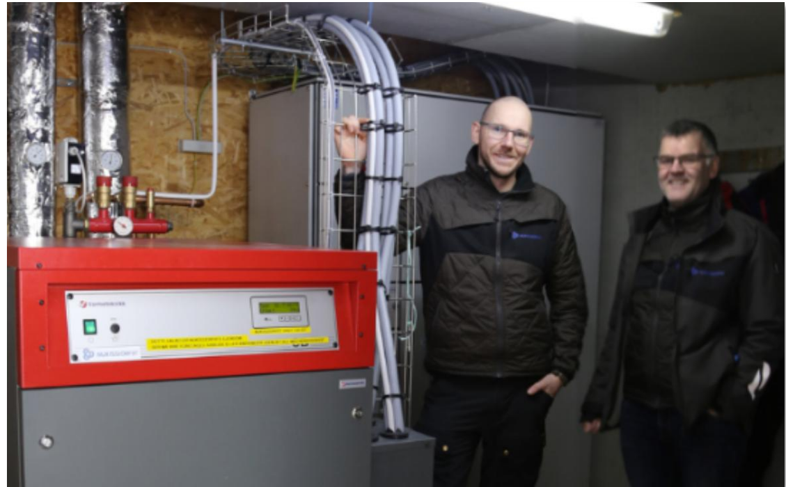
Figur 8: Igangsættelse af en elektrokedel på Hotel SØMA i Nuuk, som erstatter brug af fyringsolie og sparer 142 ton CO 2 om året (Nukissiorfiit, 2024b)
